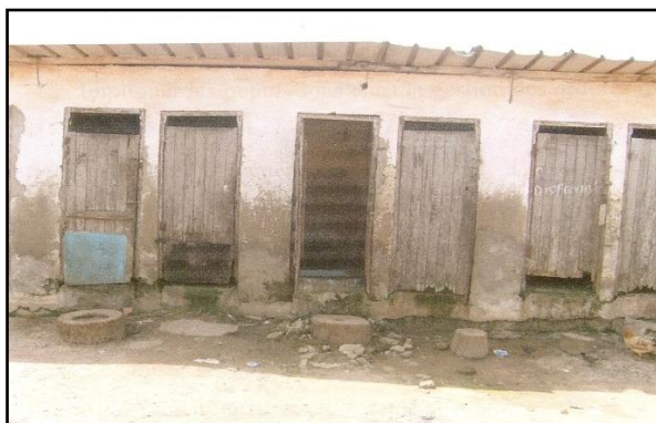
Photo 1 : W.C et douches à usage collectif dans un état délabré à la cité ouvrière de Taabo. Crédit de photographie : Bohoussou et al, 2007.
