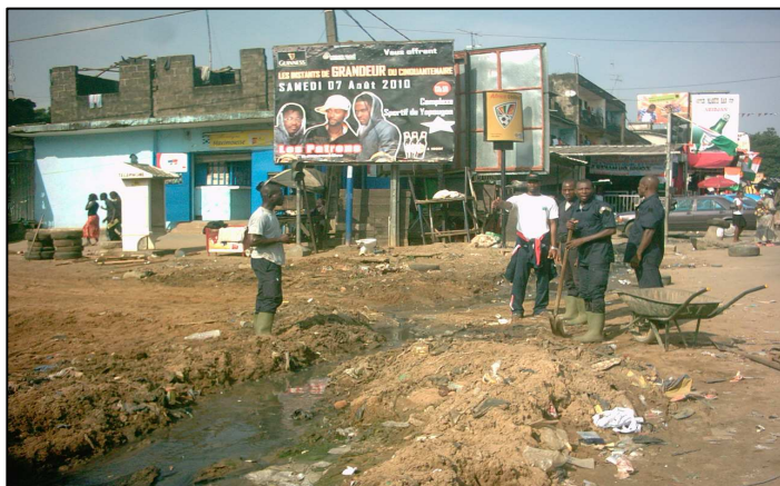
Photo 8 : La brigade de salubrité en plein travaux d'assainissement au niveau de l'ex-rue princesse à Yopougon. Photographie : Adomon, août 2010
