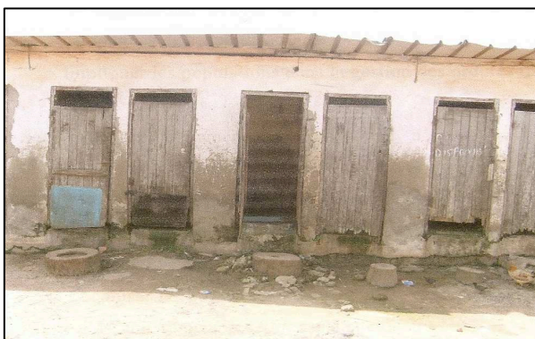
Photo 1 : W.C et douches à usage collectif dans un état délabré à la cité ouvrière de Taabo. Crédit de photographie : Bohoussou et al, 2007
